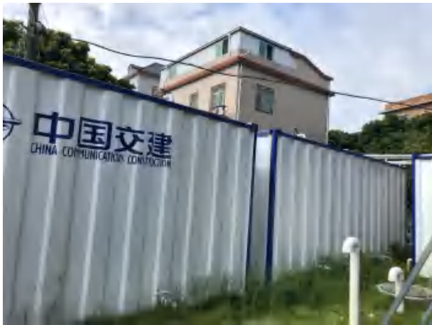
一体化污水处理设施
