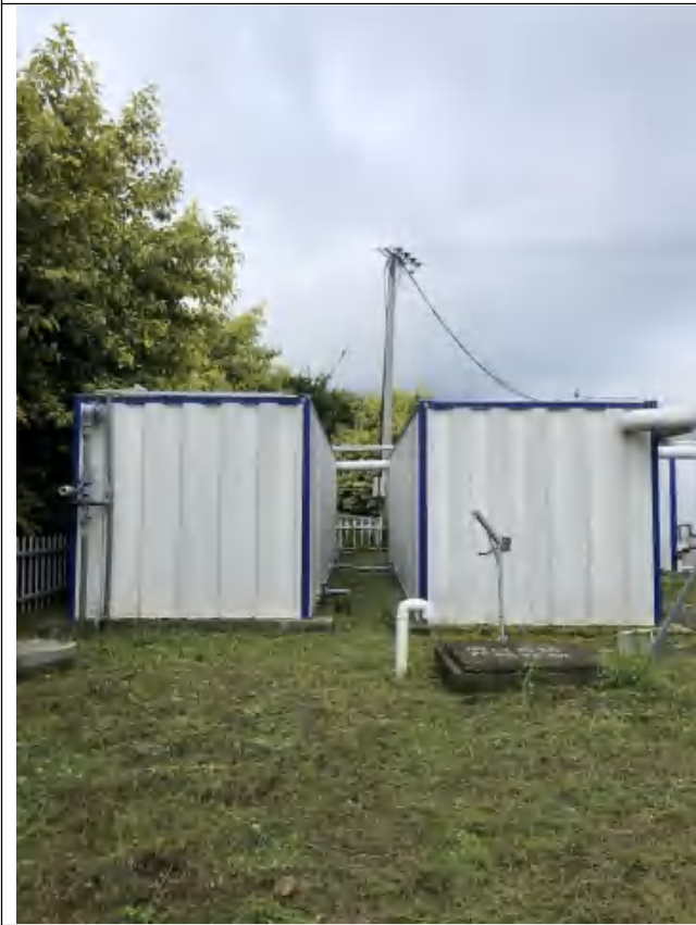
一体化污水处理设施
