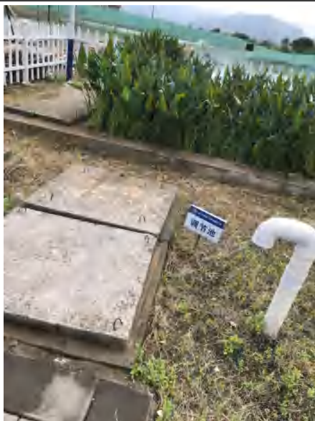
埋地密闭调节池
