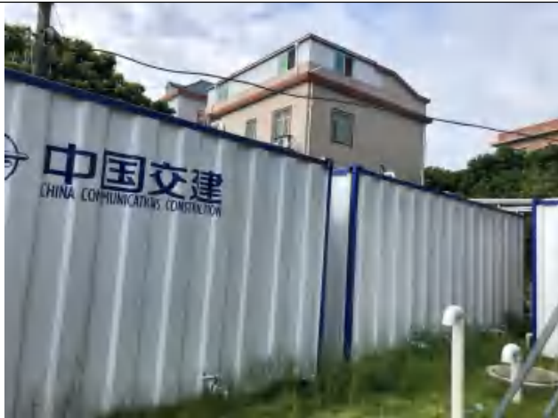
一体化污水处理设施
