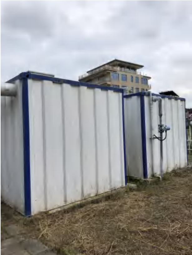
密闭污水处理设施
